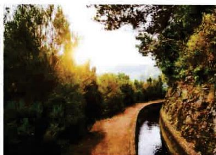
FIGURA 11 - CANAL SEM DEMARCAÇÃO
